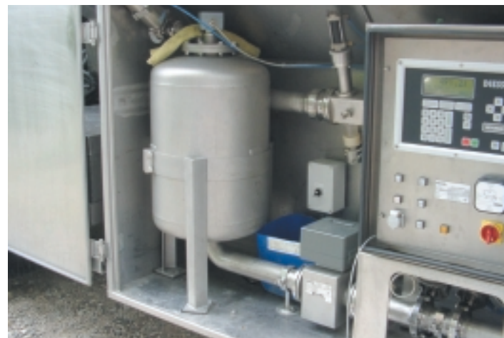
Amtliche Messanlage mit Steuerung und Datenerfassung Typ Zevodat-M
