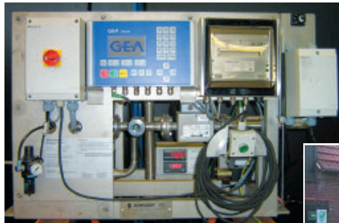
Tankwagenmessanlage mit dem neuen Datenerfassungstyp ZEVODAT-flash
