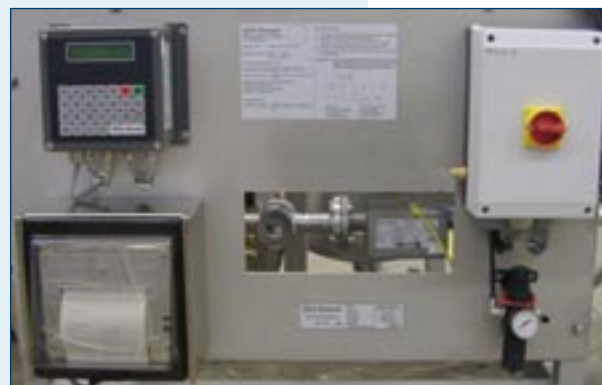
Bild 5: Messanlage für Tankwagen mit Hauptzählwerk und Drucker
