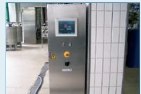
(Bild 6) Schaltschrank mit Grafikbedieneinheit
