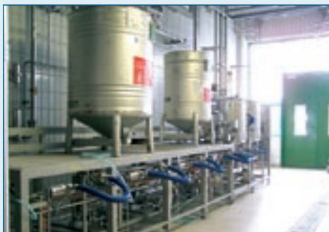
(Bild 1) Biermischanlage mit vier Containerstellplätzen und zwei fest installierten Löse- und Vorlagebehältern
