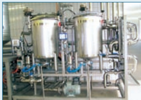
(Bild 2) Fest installierte Komponententanks für Vorlösung von Trockenstoffen
