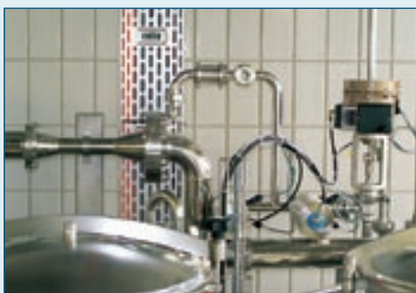
(Bild 4) CO 2 -Dosage; Injektor und Regelventil
