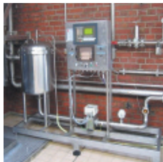
Geeichte Annahmeanlage mit Durchflusszähler, Bedienterminal und Bonabdruk
