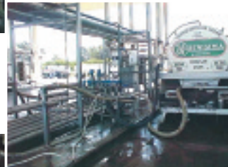
Annahmestation für Rohmilch aus Tankwagen
